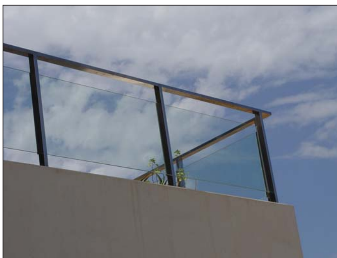
Barandilla de acero inoxidable y vidrio.
