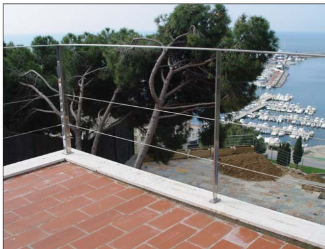
Barandilla con cable de acero inoxidable.
