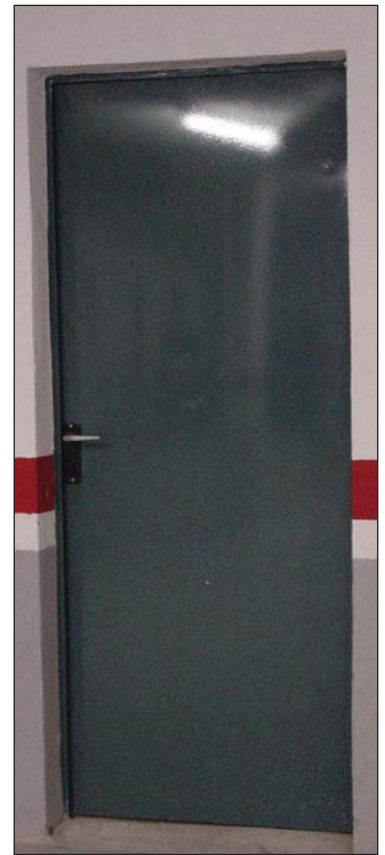
Puerta sin ventilación.
