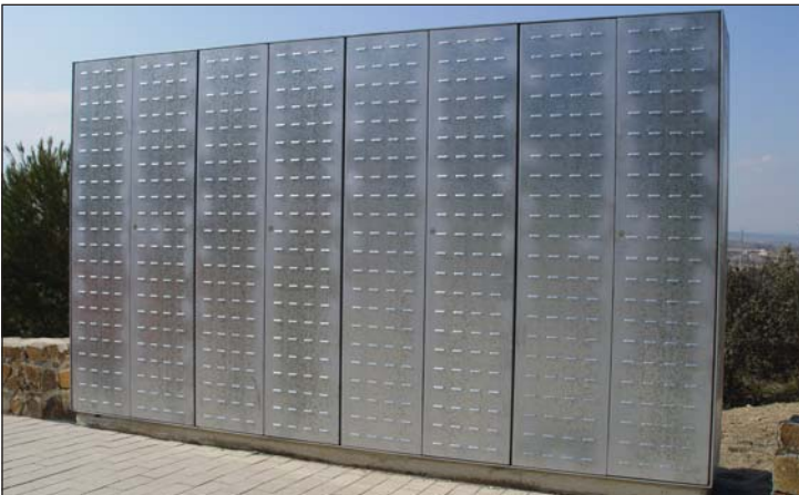
Armario agua, gas, electricidad con chapa ventilación galvanizada..
