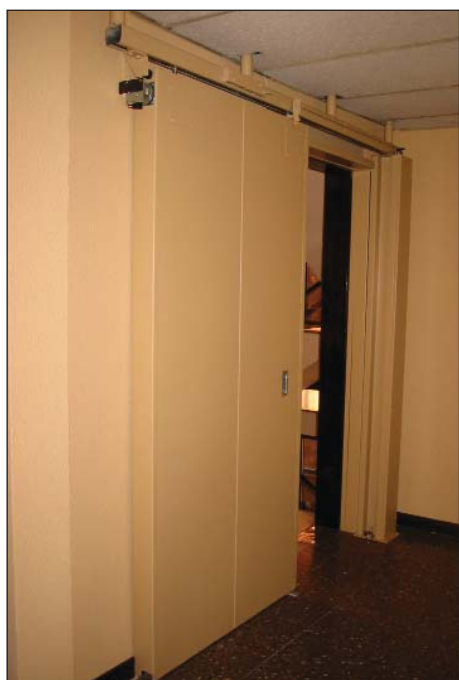
Puerta cortafuegos corredera RF-90.
