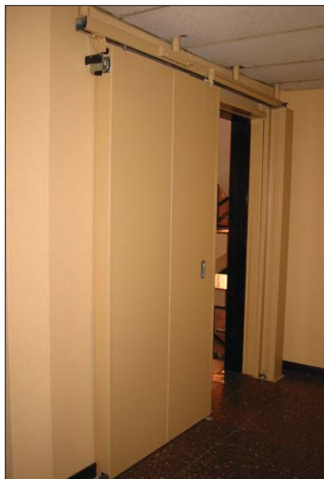
Puerta cortafuegos corredera RF-90.
