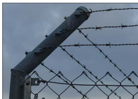
Cercado metálico con tela metálica y brazo inclinado superior con espino.
